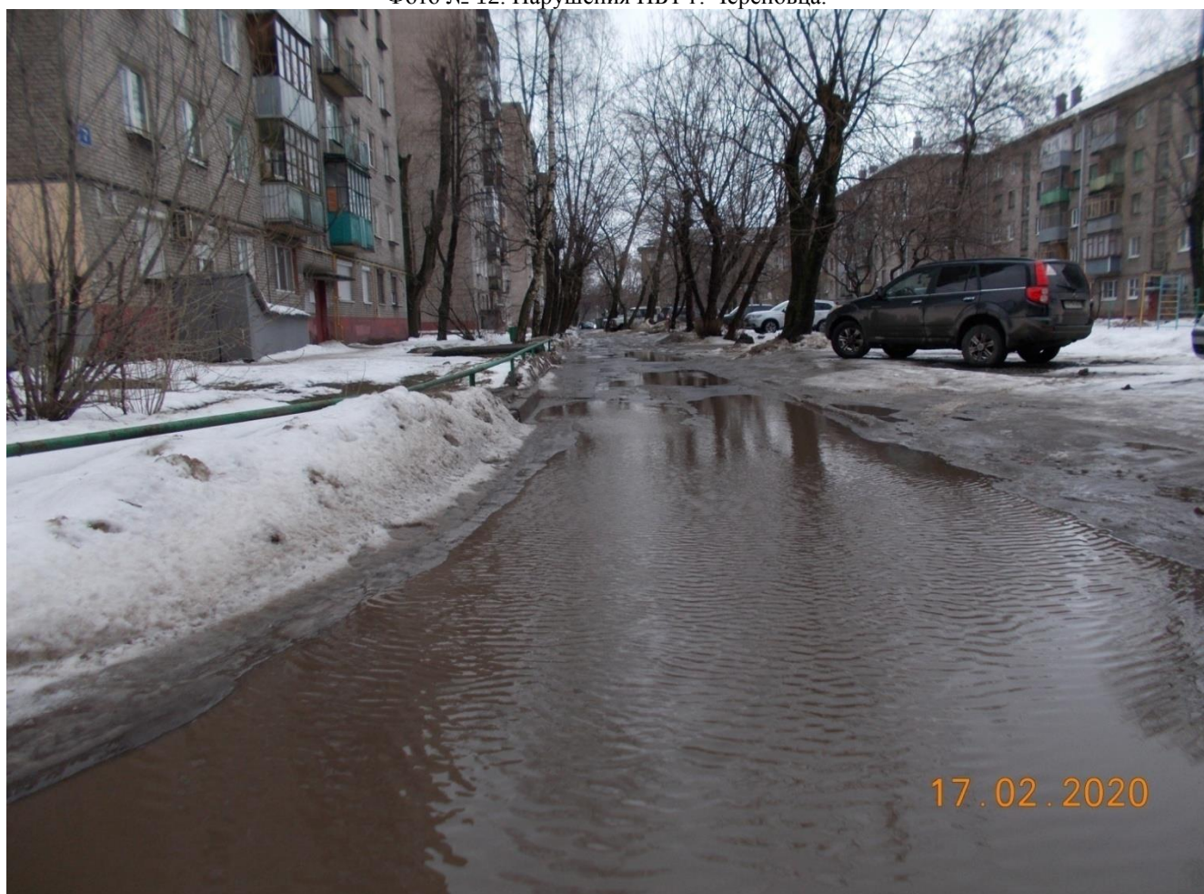
Фото № 13. Нарушения ПБТ г. Череповца.
