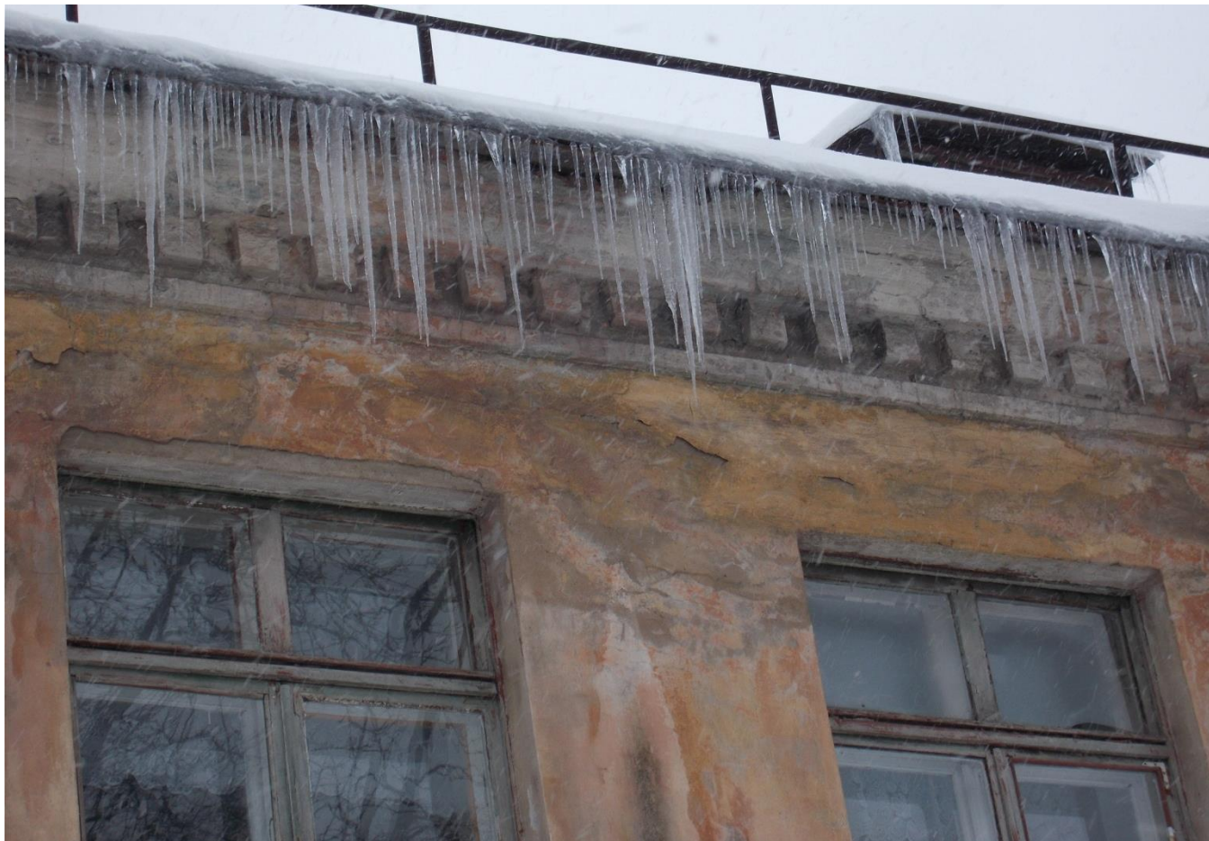
Фото № 12. Нарушения ПБТ г. Череповца.
