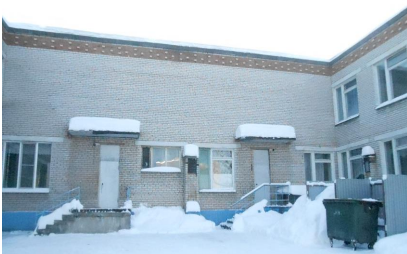
Фото №9. Детский сад №29 ул. К. Беяева, 22 (не произведена снегоочистка козырьков над входами в детский сад)
