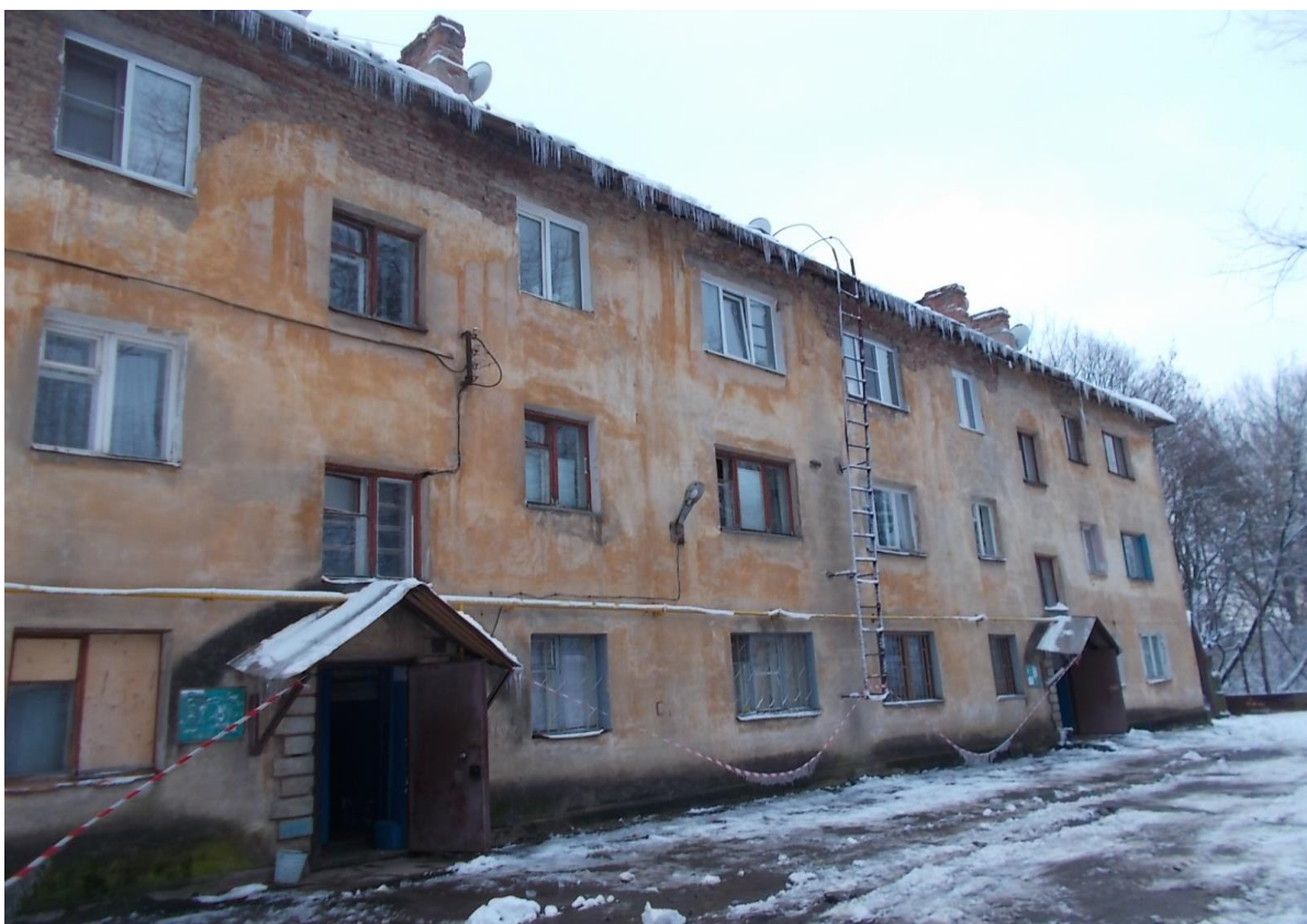
Фотография № 15 Не производится своевременная очистка кровли, выступающих частей фасада (балконов, карнизов, козырьков, водосточных труб) от снега, наледи и сосулек в весенне-зимний период; ул. М. Горького, 1
