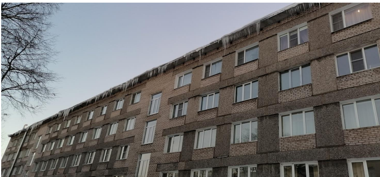
Фото № 8. Снежно-ледяные образования на кровле.
