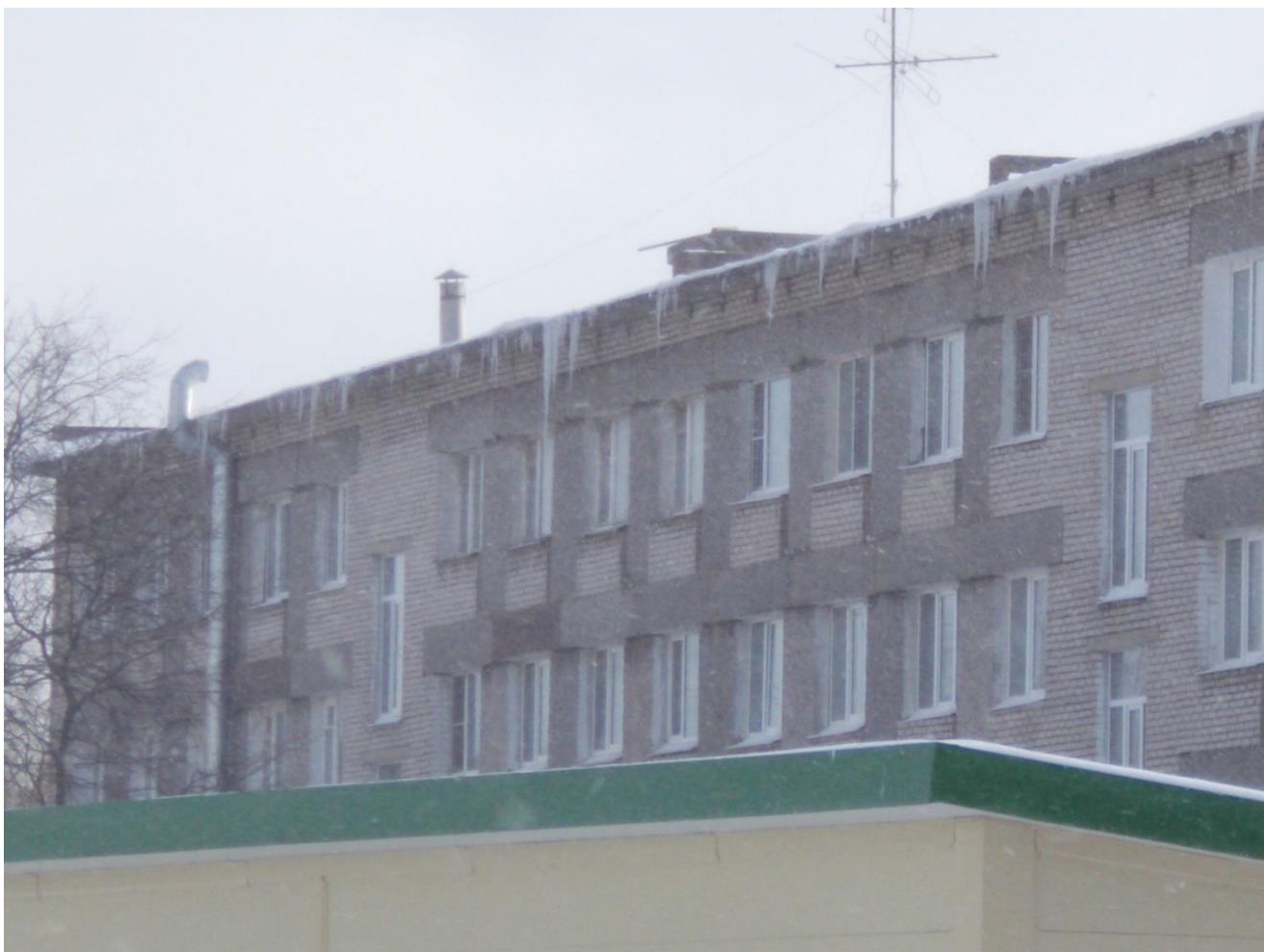
Фото № 7. Снежно-ледяные образования на кровле.
