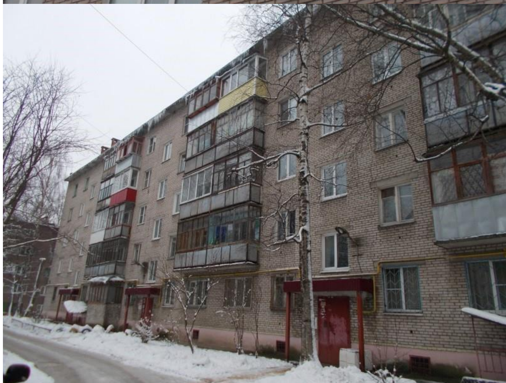
Фотография № 8,9. несвоевременная очистка кровли, выступающих частей фасада (балконов, карнизов, козырьков, водосточных труб) от снега, наледи и сосулек, создающих угрозу для жизни и здоровья граждан ул. Краснодонцев д.44А
