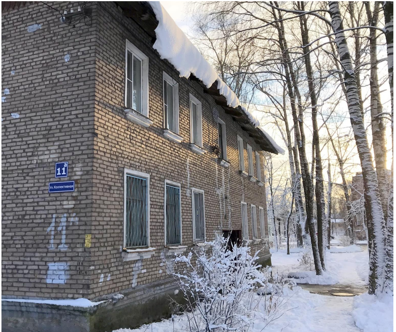
Фото № 1 Снег и наледь на кровле дома
