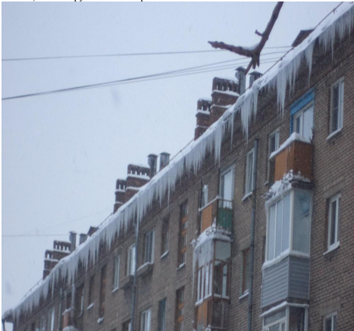
Фотография № 7. Снежно-ледяные образования на кровле дома угрожающие жизни и здоровью людей.
