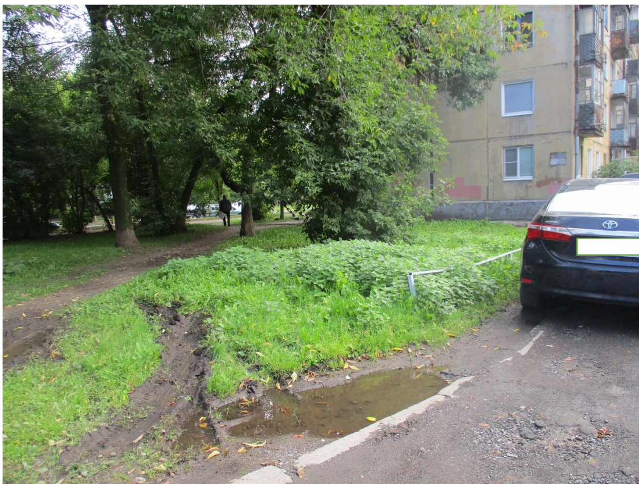
Фотография № 32 «Повреждение газона»
