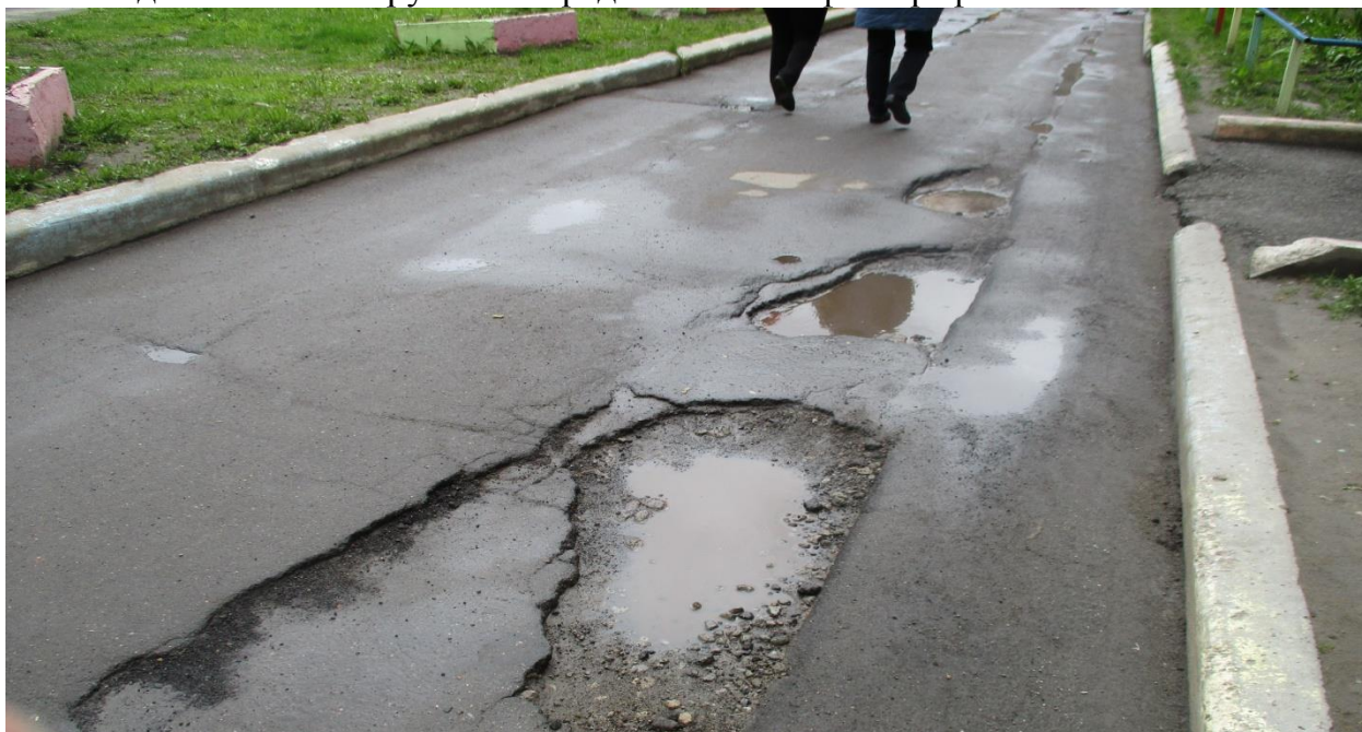
Фотография № 31 «Ямы на придомовом проезде»
