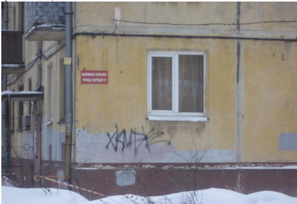
Фотография № 6. Несанкционированные надписи на фасаде дома.
