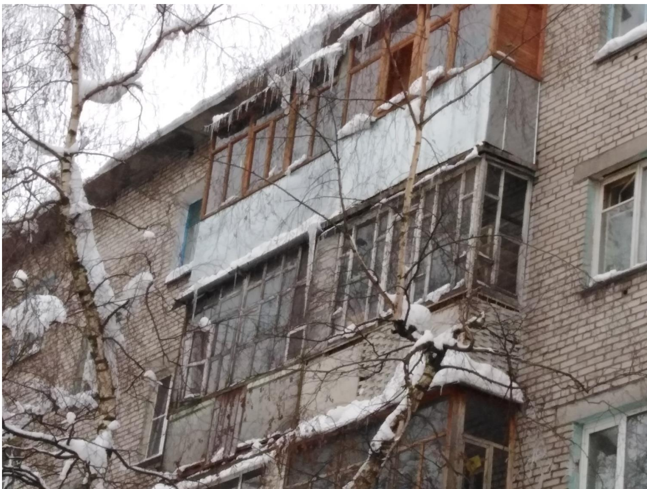
Фото № 7. Снежно-ледяные образования на кровле.
