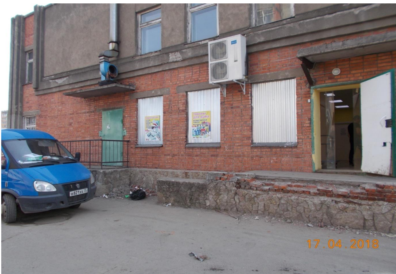
Фото № 8. Повреждение фасадов зданий.
