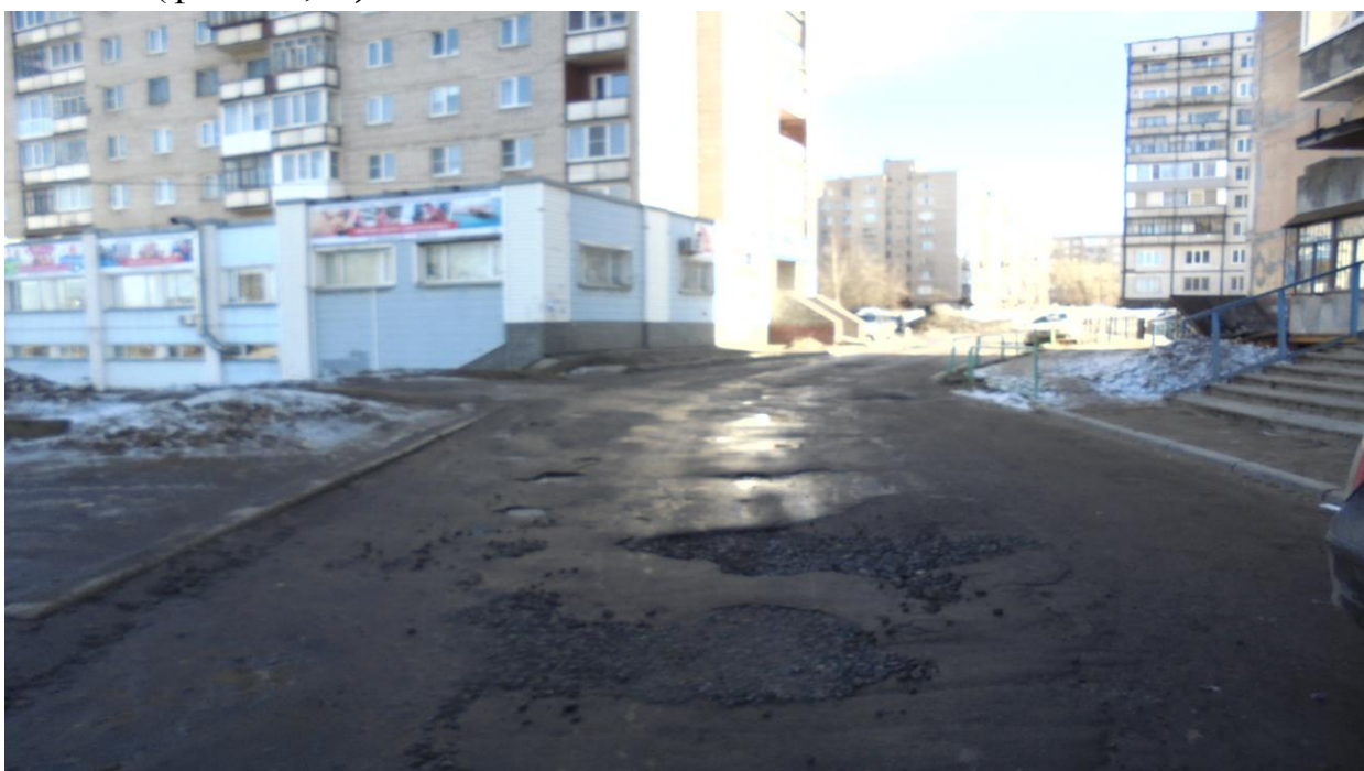
Фото 11. Дворовая территория у дома № 26 А по ул. Химиков (до ремонта)
