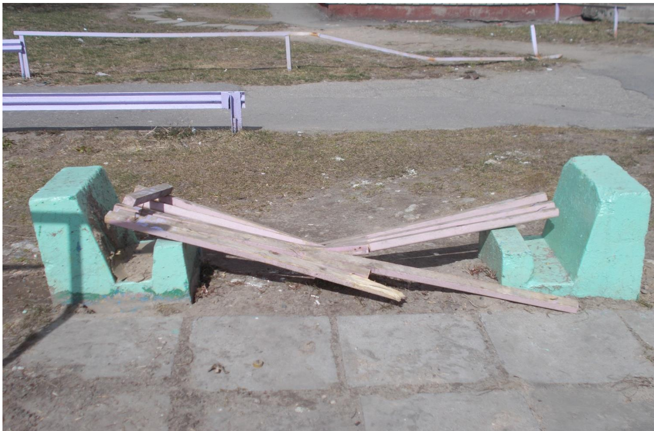
Повреждение малой архитектурной формы (скамейки)
