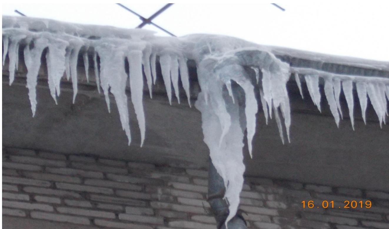
Сосульки на крыше дома
