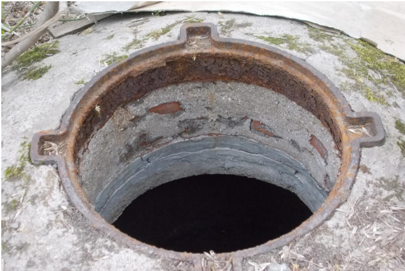
Открытый люк смотрового колодца
