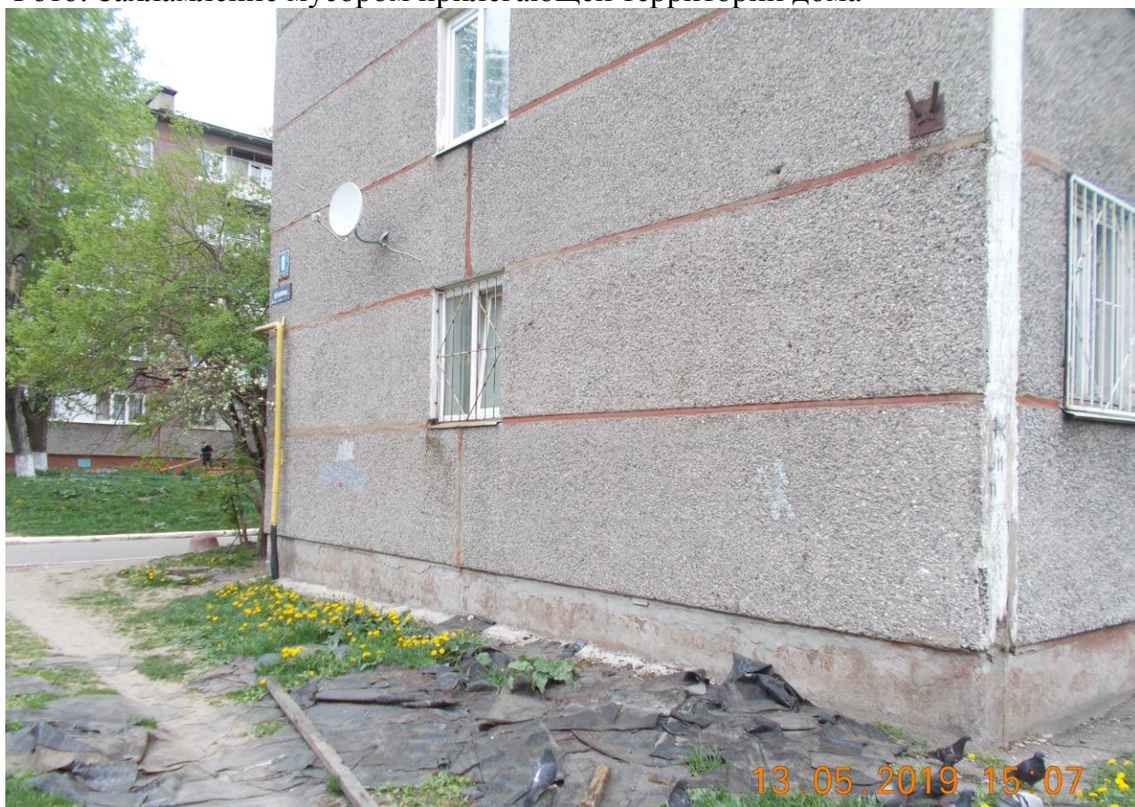
Фото: Захламление мусором прилегающей территории дома
