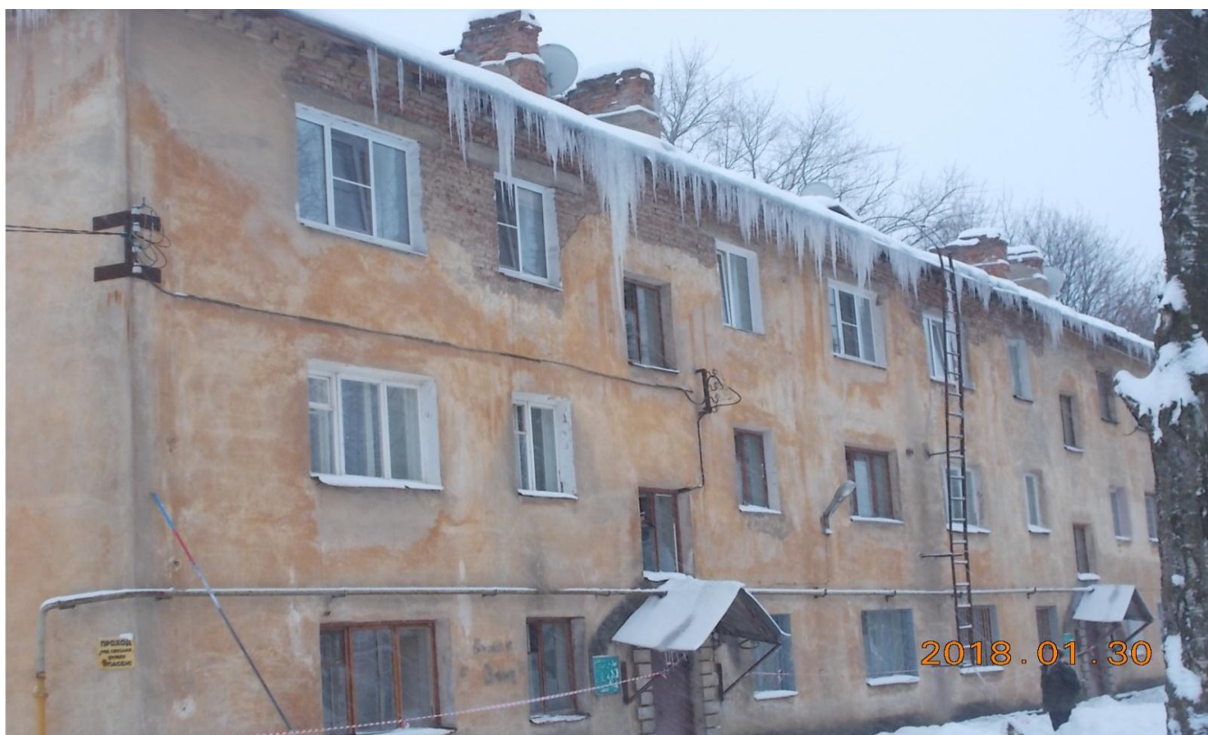
Фото 12. Не производится своевременная очистка кровли, выступающих частей фасада (балконов, карнизов, козырьков, водосточных труб) от снега, наледи и сосулек в весенне-зимний период; ул. Горького, 1
