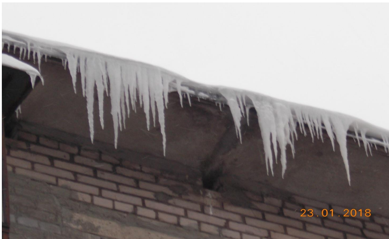
Сосульки на крыше дома
