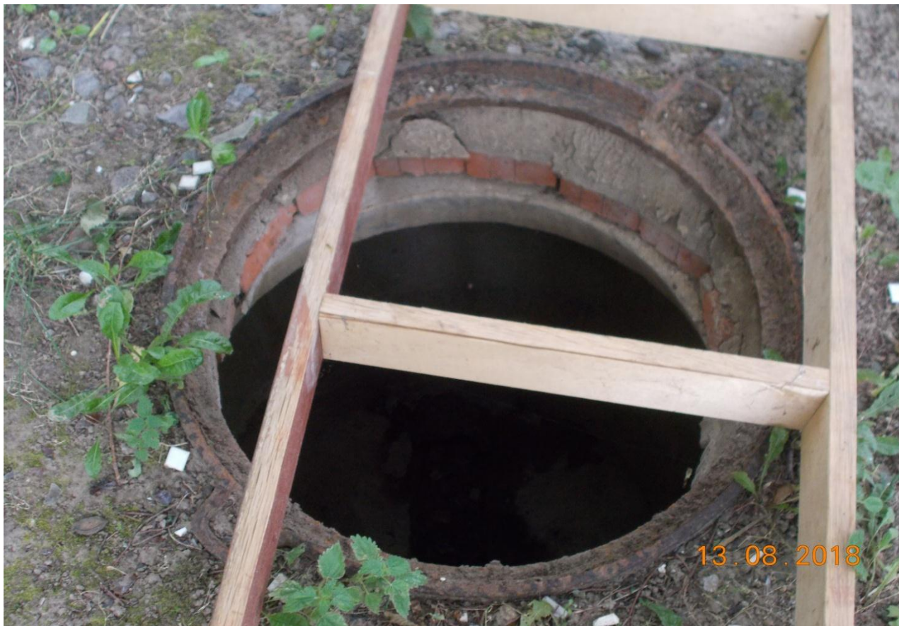
Открытый люк смотрового колодца
