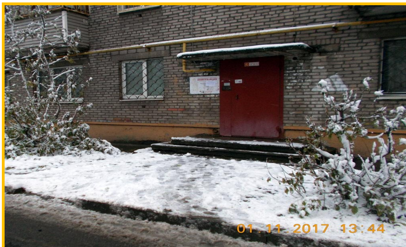
Фото № 11. Нарушения Правил благоустройства г. Череповца.
