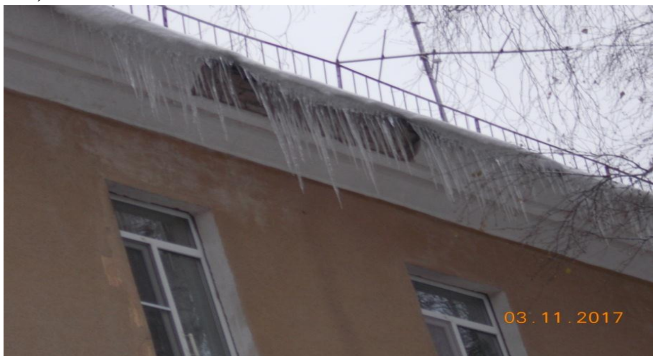
Фото № 3 . Сосульки на крыше дома.
