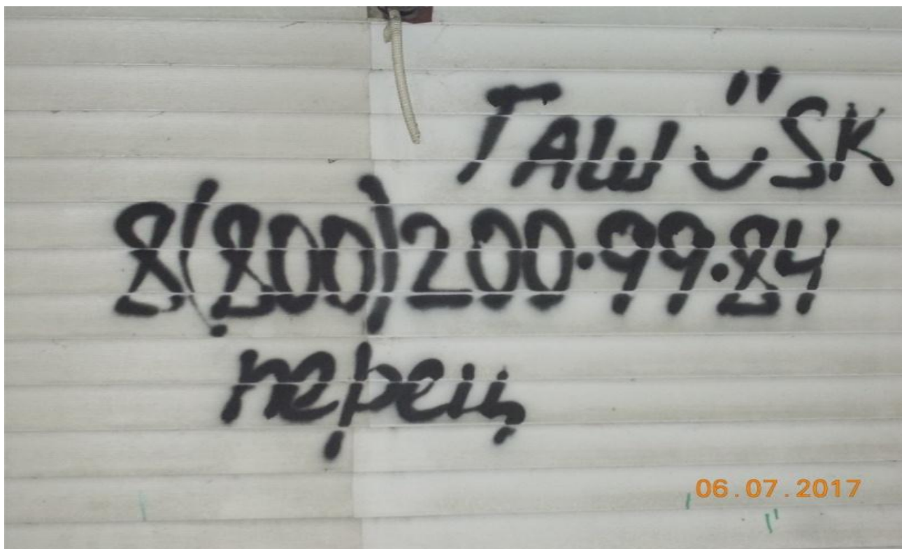
Фото №4. Несанкционированные надписи на фасадах домов.
