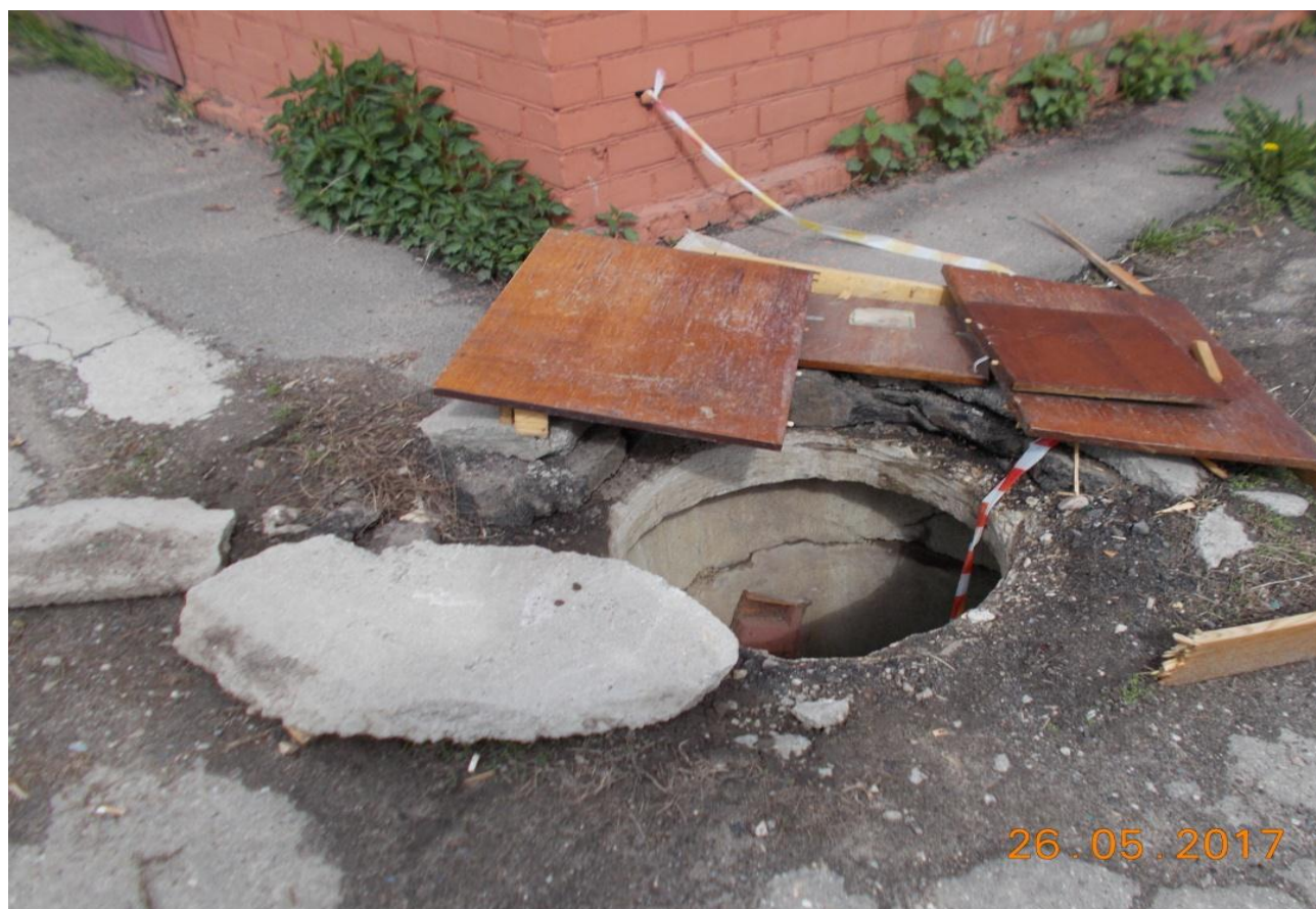
Фото № 4. Отсутствие крышки канализационного люка.
