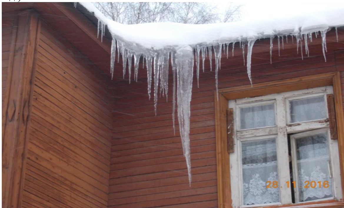
Фото № 5. Сосульки на крыше дома.
