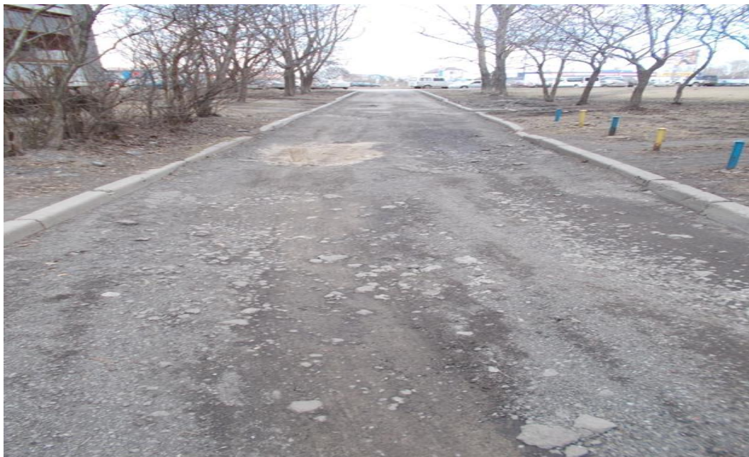
Фото № 10. Плохое асфальтовое покрытие на внутридомовых территориях, принадлежащих ТСЖ и ЖСК.
