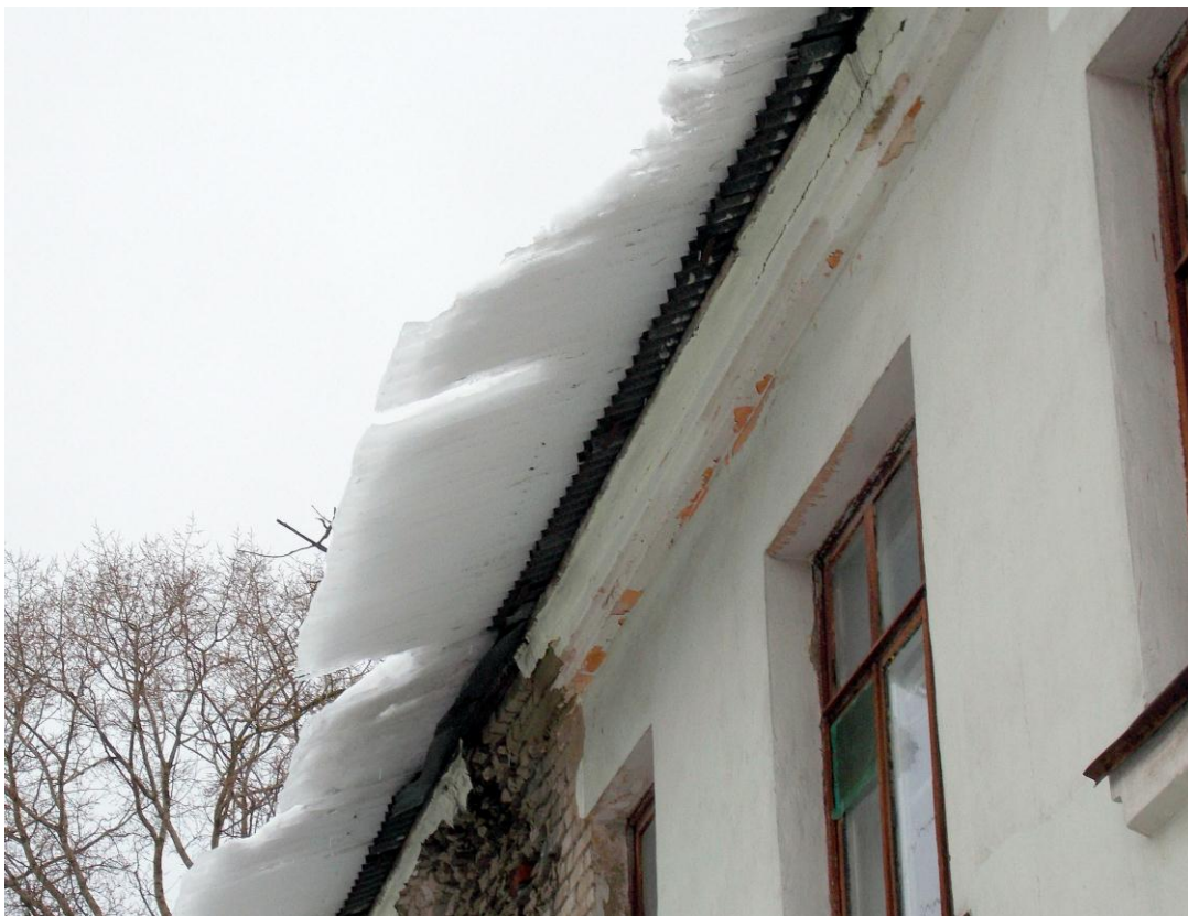
Снег и наледь на кровле жилого дома
